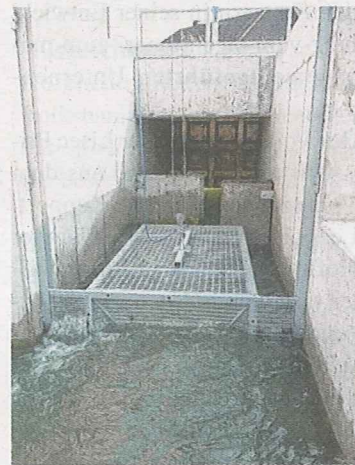
Mittels dieser Reuse wurde die Anzahl der aufgestiegenen Fische gezählt.
