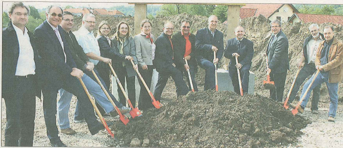
Beim Spatenstich: (v.l.) Ing. Johann Knöll, Prokurist Held & Francke, Ing. Robert Doppler, Geschäftsführer der Firma Kössler Turbinenbau, EU-Vertreter Dr. Felix Bergmann, Bürgermeister Gernot Lechner, Mag. Astrid Aumayr, BH Amstetten, Mag. Elisabeth Schedy, NÖ Landesregierung Wasserrecht, Stadträtin Brigitte Kashofer, Vizebürgermeister Dieter Funke, Stadtrat Ing. Anton Katzengruber, Bürgermeister Herbert Katzengruber, Umweltgemeinderat Bernhard Wagner, Direktor Ing. Robert Simmer, Dr. Erhard Kraus, NÖ Landesregierung und Hofrat DI Erich Czeiner, NÖ Landesregierung.
